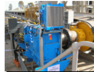
Motore da 900 kW asservito da PLC 900 kW Motor interlocked with a PLC
